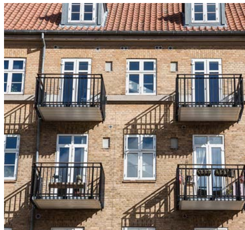
Foto: Altaner opsat i kolonner. De spinkle værn og tynde altanbunde får altanen til at fremtræde let og harmonisk.
